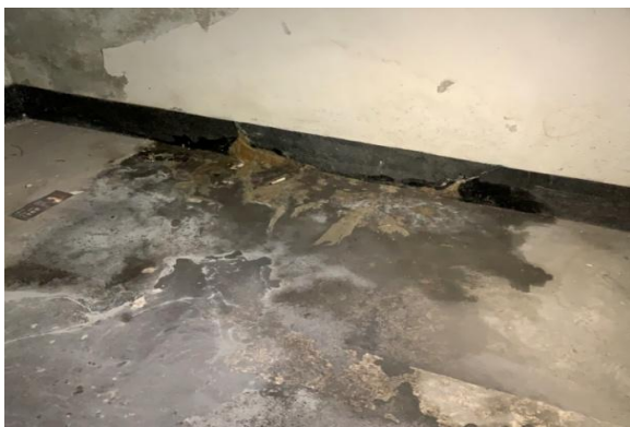
上海某小区地下室渗漏水现象
