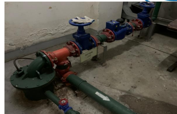
上海某应急备用井渗漏水现象
